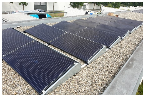
Panelen geplaatst op platte daken met afstand tot de dakrand.
